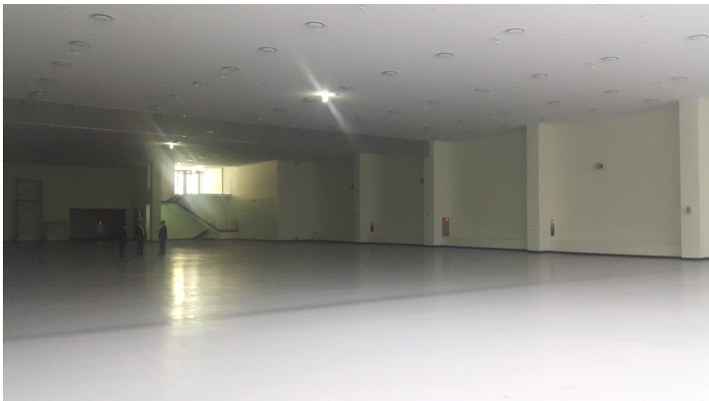
[사진2] 이 사건 건축물의 내부 현황 10)
